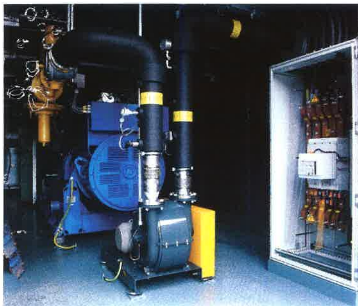
Moteur de cogénération biogaz en container.
