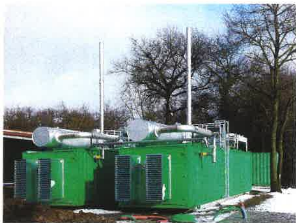
Moteurs de cogénération installés sur le site d'enfouissement de déchets de Chézy(03)
